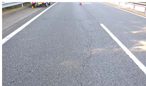
写真-2 ひび割れ状況例
